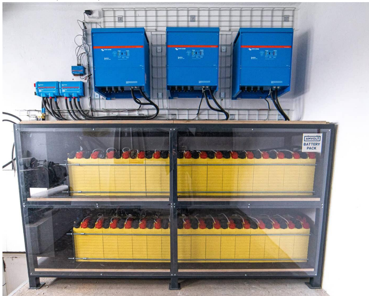
Obrázek 16 Sestava pro solární aplikace, střídače a bateriové úložiště 100 kW
